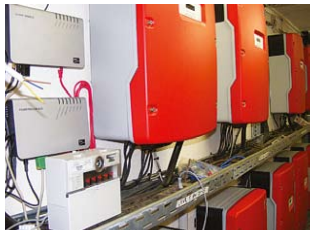
3. ábra RKV, Power Reducer Box és az inverterek (telepítés közbeni állapot)
