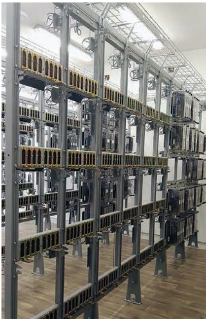
5. kép: Simontornya állomás, új jelfogó helyiség
