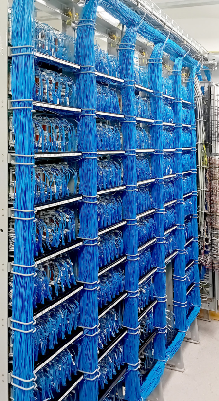
Hinterseite der Relaisgestellen, mit riesigen Einzelverdrahtung
